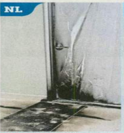
En Sabinas, NL, la puerta de un hospital para atender pacientes de Covid fue vandalizada. Y en Campeche y Veracruz, los pobladores instalaron retenes para impedir el paso a visitantes.
